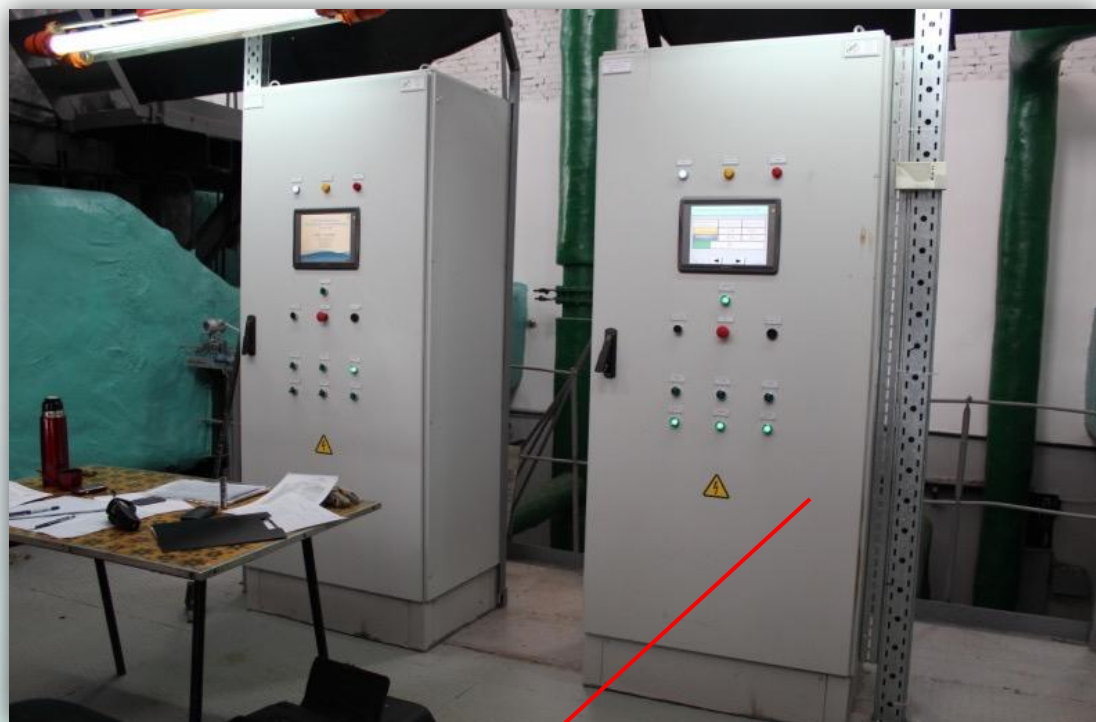
Шкафы автоматического управления
